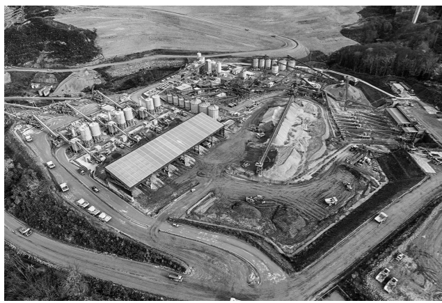
骨材製造設備全景
