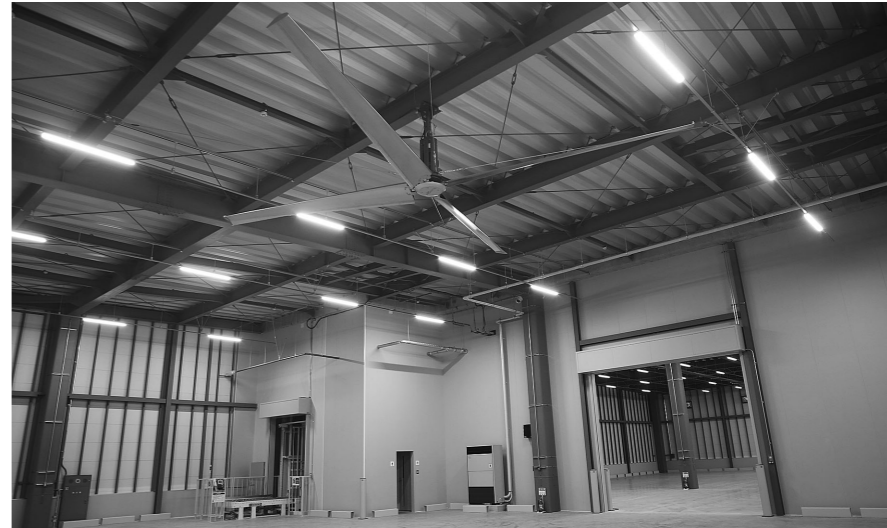
倉庫内に設置したファン
