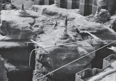
写真7 柱状浸透注入工法・エキスパッカ工法による低炭素グラウト「ハイブリッドシリカ」の高強度柱状連続固結柱
