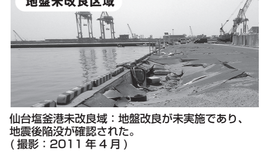
仙台塩釜港未改良地盤:地盤改良が未実施であり、地震後被害が確認された。 (撮影:2011年4月)
