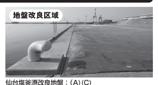
仙台塩釜港改良地盤:(A)(C) 地震後被害なし (施工:2007年・撮影:2011年4月)
