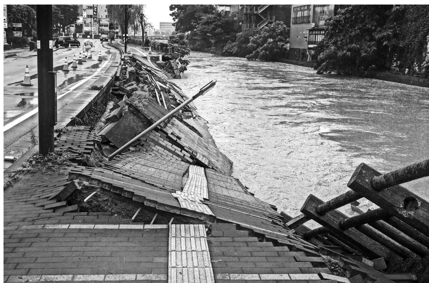
崩落した旭川路肩
