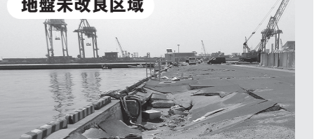
仙台塩釜港 未改良区域: 地盤改良が未実施であり、地震後陥没が確認された。(撮影:平成23年4月)
