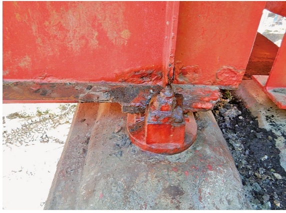
雨水で腐食した橋梁の鋼支承と鋼桁端部 (東京都提供)
