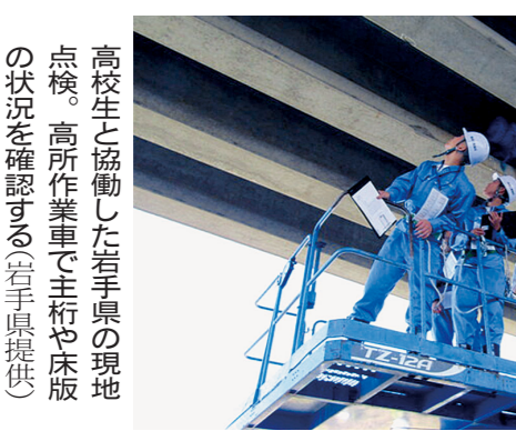
高校生と協働した岩手県の現地点検。高所作業車を手回しで床版の状況を確認する(岩手県提供)
