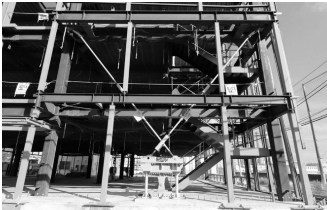
実物件に初適用された揺動制震システム
