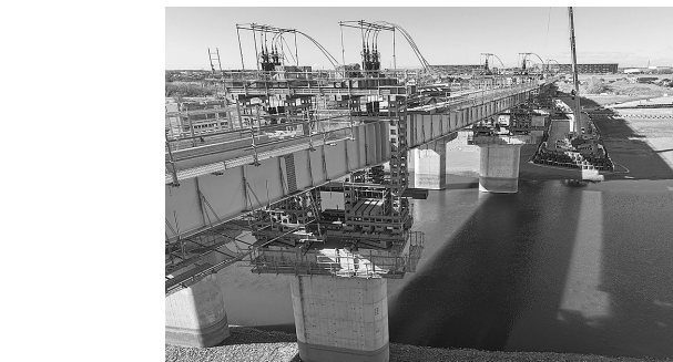
つり下げ降下設備設置状況
