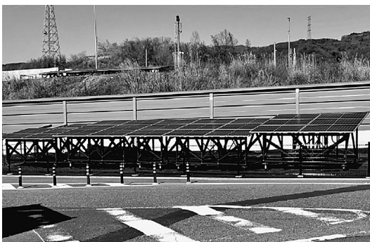
パーキングエリア内の太陽光パネル
