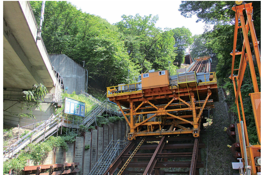
急斜面を動く巨大斜行エレベーター「インクライン」
