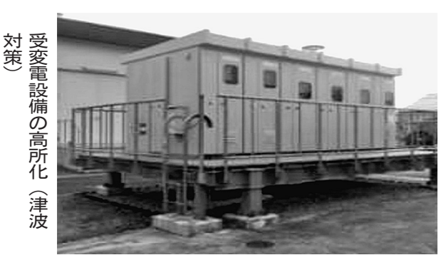
受変電設備の高所化(津波対策)
