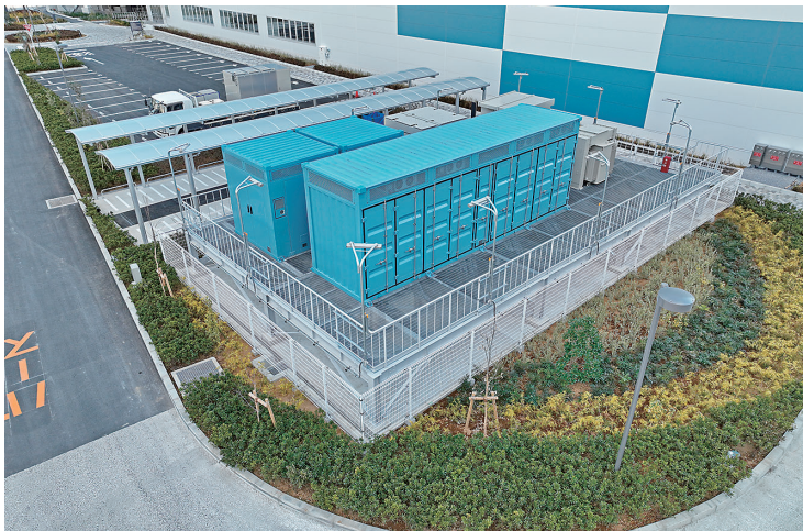
大型蓄電池設備 (写真提供: 雁光舎)
