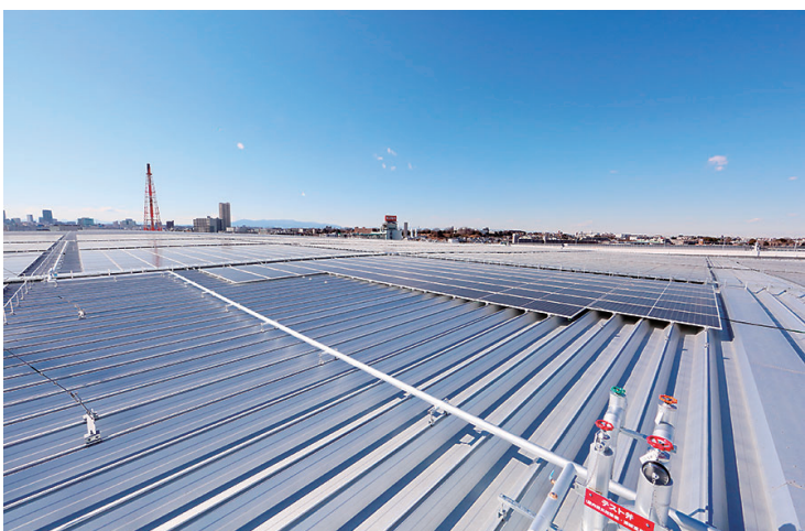
屋上の太陽光パネル
