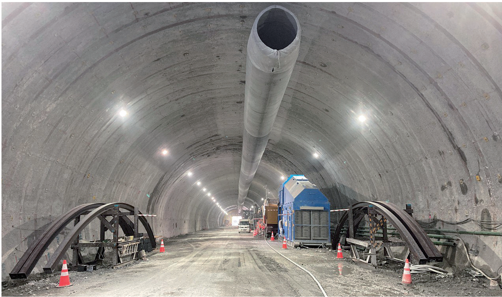
LED照明を2列配置
