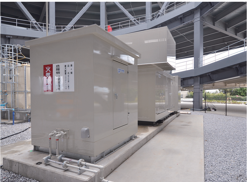
非常用自家発電設備
