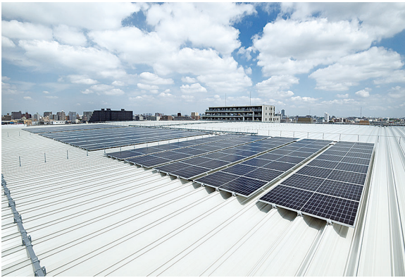
太陽光パネル
